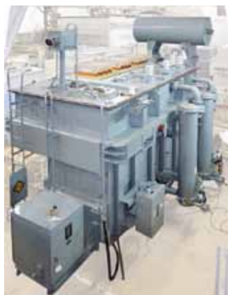
OFWF-50Hz-80 (96:OL) MVA-22kV \Delta -F900 ~ R660 ~ 420V open \Delta (24V step 21taps)
